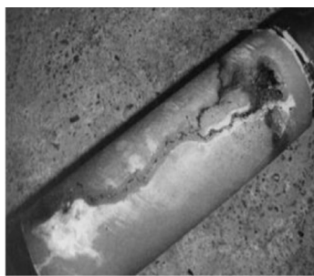
图14 故障现场电缆护层故障图
